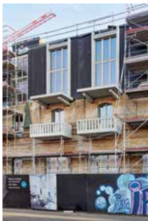
«Stadhäuser» an der Jägerstrasse: Strassenansicht nach der Transformation / Detail Fassadenschnitt/ Realisierung, ARGE KilgaPopp und Baumberger & Stegmeier 2023
